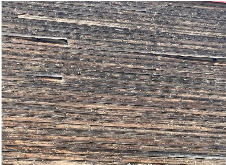
Uszkodzenia elewacji wykończonej elementami drewnianymi
